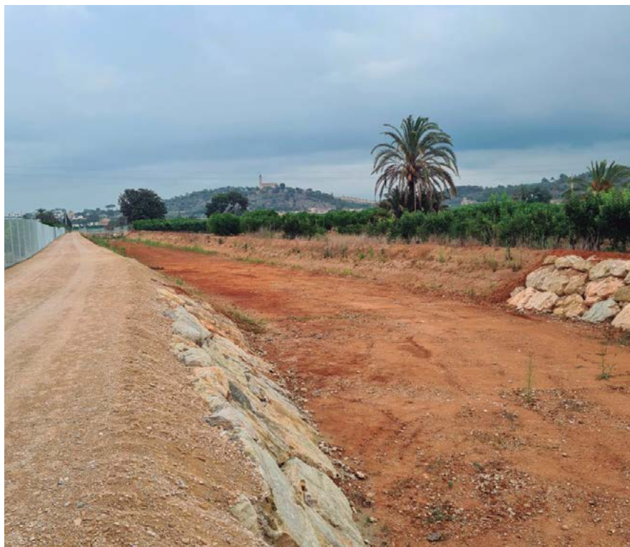
El canal interceptor de riadas del Plan Municipal ante el Riesgo de Inundaciones (PAMRI) del Ayuntamiento de Alzira (C. Valenciana).
